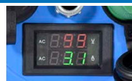
■負荷時 電圧:99V(電圧降下している) 電流:3.1Aを表示
